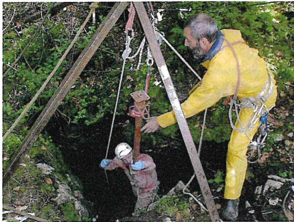
Didier et Vincent en plein travaux pour stocker les déblais de déSTRUCTION.
